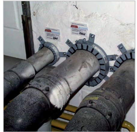
Kuhn Brandschutz Systeme
